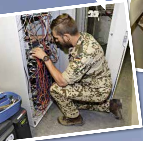
Oben: mein Schreibtisch im Einsatz Rechts/unten: Ich tausche veraltete Server aus und prüfe Kabel
